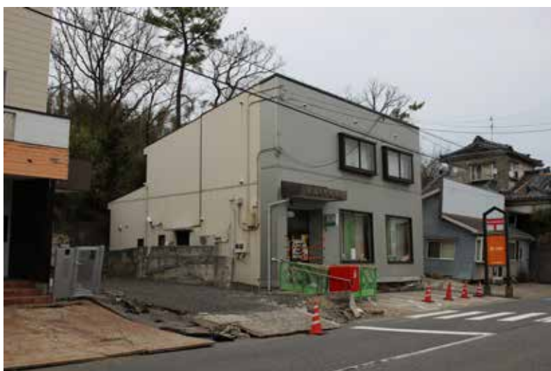
「令和6年能登半島地震」における新潟市西区の液状化被害の様子 新潟砂丘の南の縁で液状化被害が発生し、特に西川の攻撃斜面になっている箇所周辺での被害が酷かった。側方流動によりローテーションして、郵便局が後ろ向きに、その奥の建物が前向きに傾いている。(2024年3月28日小荒井撮影)
